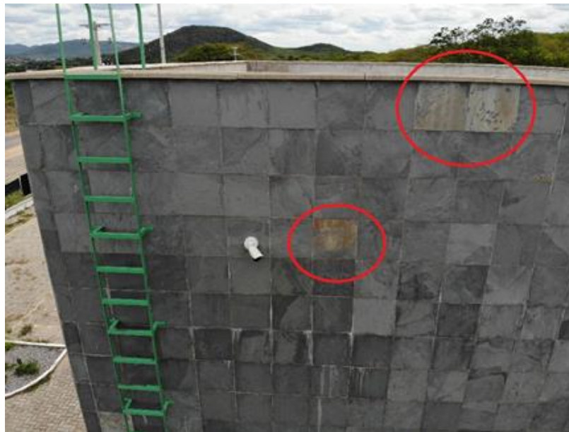
Figura 7 - Manchas encontradas no Auditório da Instituição
