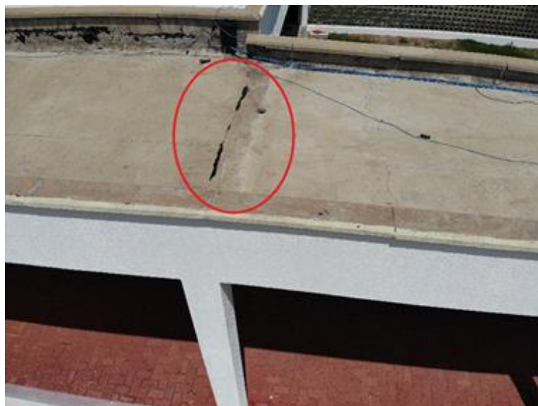
Figura 9 - Fenda encontrada na cobertura da Cantina da Instituição
