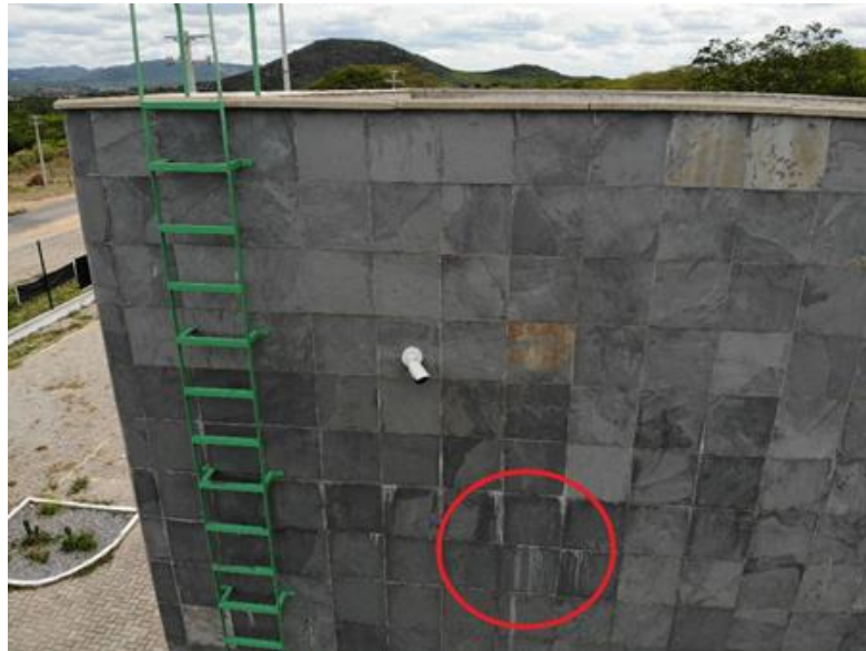
Figura 6 - Eflorescência encontrada no Auditório da Instituição
