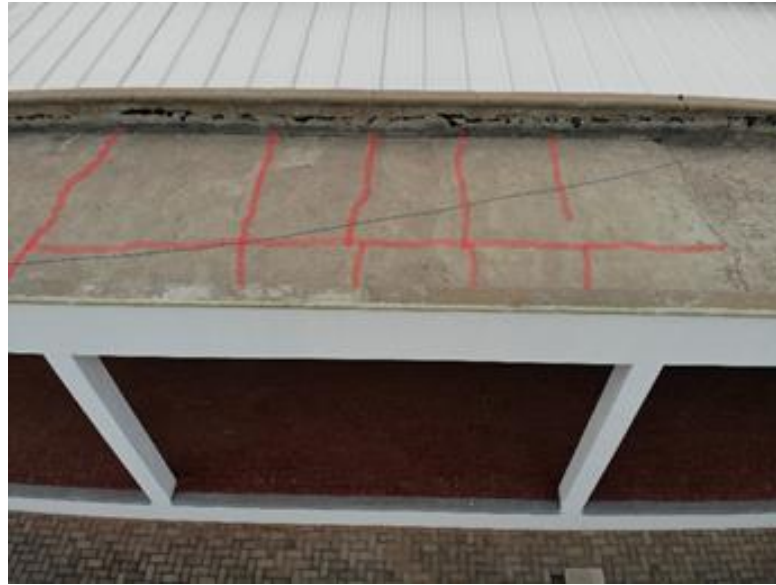
Figura 8 - Fissuras encontradas na Cantina da Instituição
