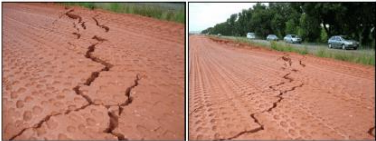
Figura 6- Fissuras de tração abertas após ruptura de um aterro sobre solos moles.
